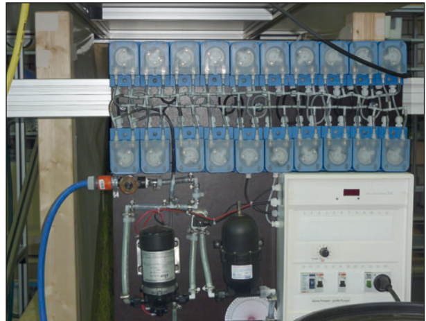
Bild 8: Detailaufnahme des Pumpensystems und der Steuerungseinheit
