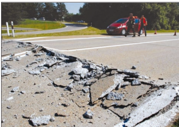
Bild 59: Hitzeschaden (Blow-up) auf der A93 in Niederbayern im Juni 2013 [NEFZGER 2013]
