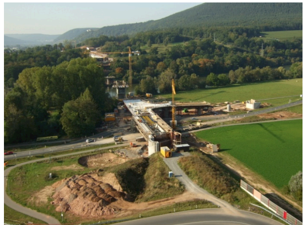
Bild 2: Bau des Herzstückes; Quelle: Büchting+Streit AG für die Auffahrt von der Staatsstraße 2310 auf die St 2309.
