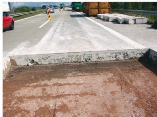
f. Ansicht der Querschnittsfuge mit durchtrennten Stabdübeln
