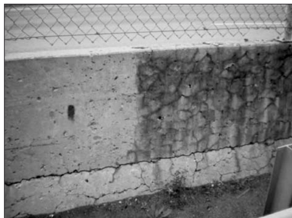
Bild 12: Silanbehandelte (links) und unbehandelte (rechts) Oberfläche von Betonschutzwänden in Sainte-Foy (Quebec, Kanada) [20]
