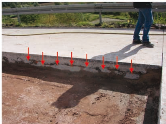
e. Erkennbarkeit Horizontalriss in Längsfuge zwischen 1. Fahrstreifen und Standstreifen in Höhe der Anker
