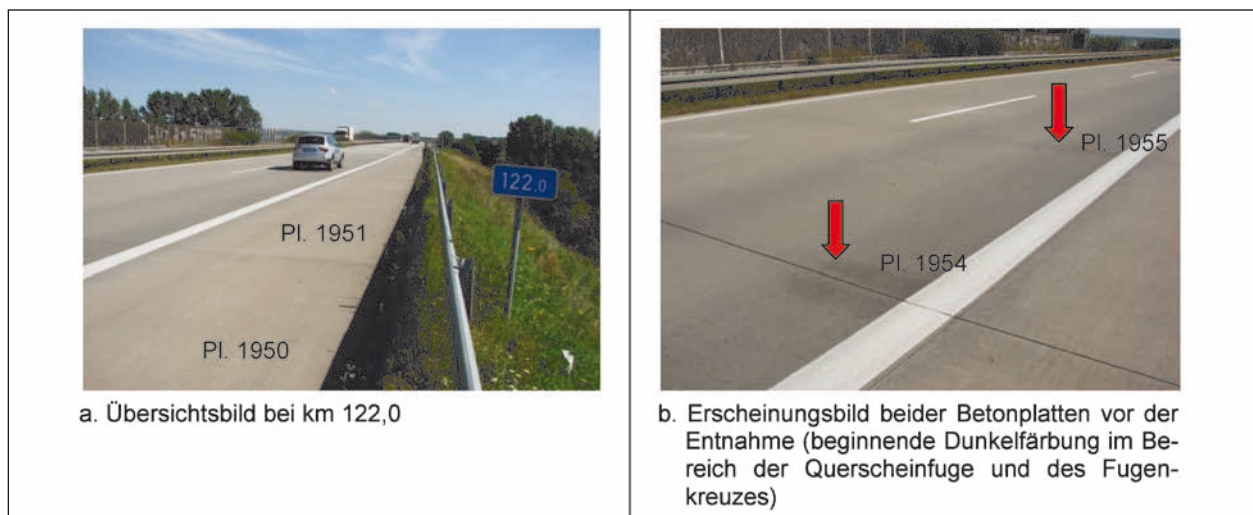
Bild 15: Zustand der Betonfahrbahndecke auf der BAB A 14 bei Autobahnkilometer 122,0 in Fahrtrichtung Halle/Saale vor der Plattentnahme
