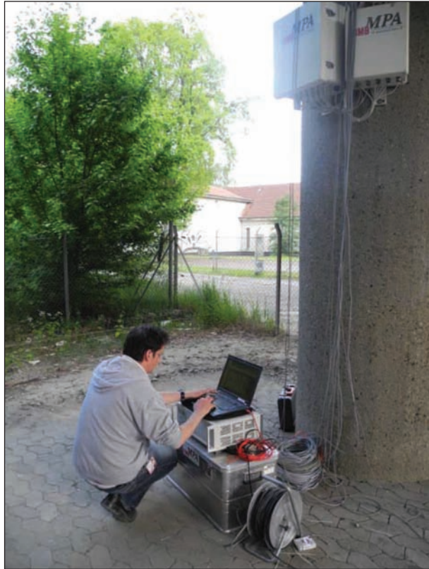
Bild 6-27: Mobile Messzentrale zur Datenerfassung des sekundären temporären dynamischen Messsystems mit Messrechner und Vielstellenmessgerät MGC+ der Firma HBM
