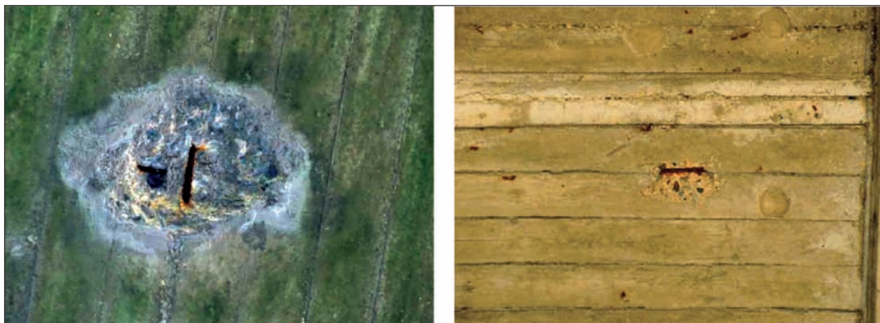
Bild 6-4: Abplatzungen an der Fahrbahnplattenunterseite
