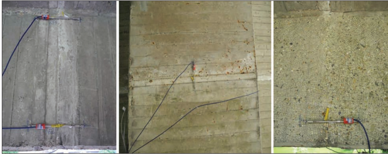
Bild 6-23: Ausgeführte primäre Sensorik als Kompensationsmaßnahme für das Ermüdungsdefizit im Koppelfugenbereich (Position 3)
