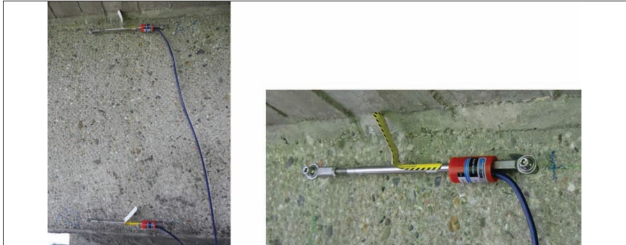
Bild 6-18: Ausgeführte primäre Sensorik als Kompensationsmaßnahme für das Biegedefizit (Position 2a) im Auflagerbereich mit Sensordetail (gelenkige Ausführung mit Kugelköpfen)
