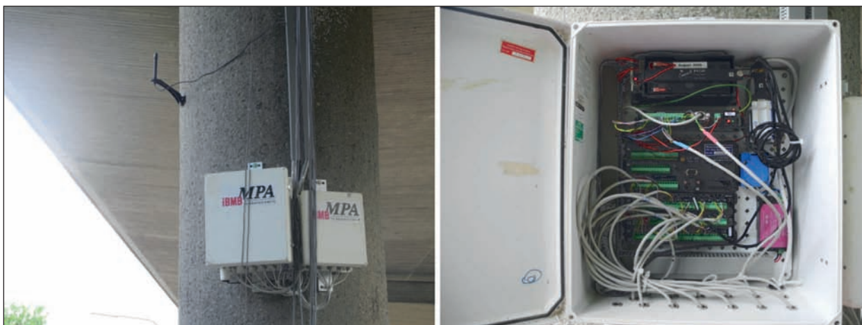
Bild 6-13: Messzentrale zur Datenerfassung des primären permanenten statischen Messsystems mit GSM-Antenne (links) und Messschränken
