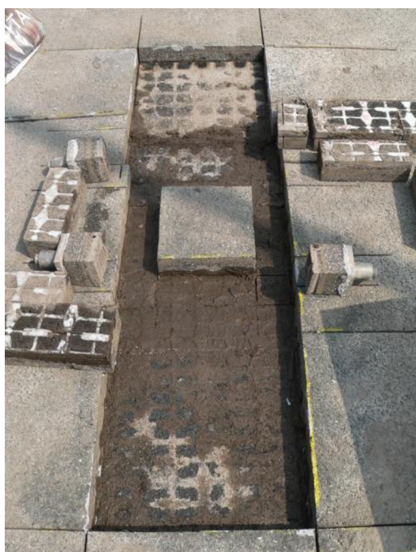
Bild 28: Großflächig entfernte Zwischen- und Deckschicht
