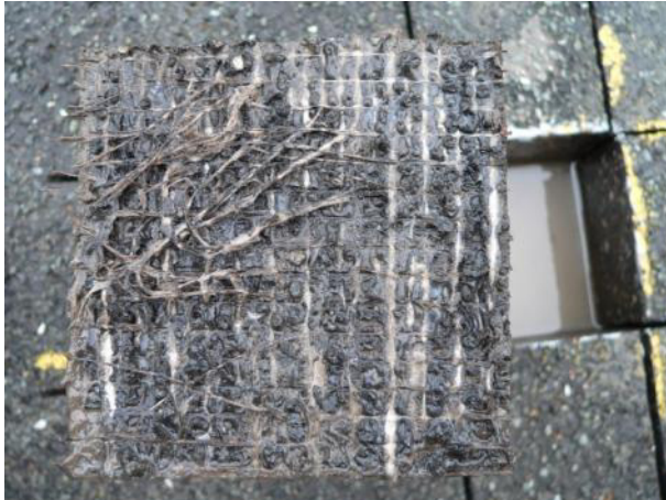
Bild 34: Verbundversagen zwischen der Schutzschicht und der Pufferschicht in Höhe des Vlieses, Prüfkörper 100 mm x 100 mm
