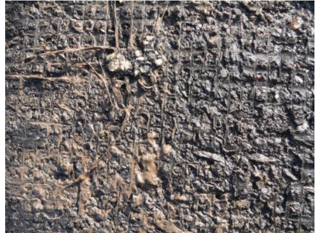
Bild 37: Verbundversagen zwischen der Schutzschicht und der Pufferschicht in Höhe des Vlieses, Prüfkörper 500 mm x 500 mm
