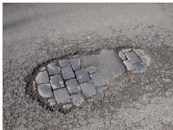
Bild 19: Beispiel eines Ausbruchs
