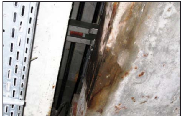
Bild 3.3: Vorderseite des nördlichen Widerlagers. Feuchte Stellen und Rostflecken auf der Betonfläche sind klar erkennbar (aus Bauwerksbuch)
