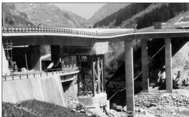
Bild 5.4: Brückenträger aus Spannbeton der Reussbrücke Wassen (CH) nach Absacken des Pfeilers um ca. 1,2 m (aus ZILCH, ZEHETMAIER, 2010)
