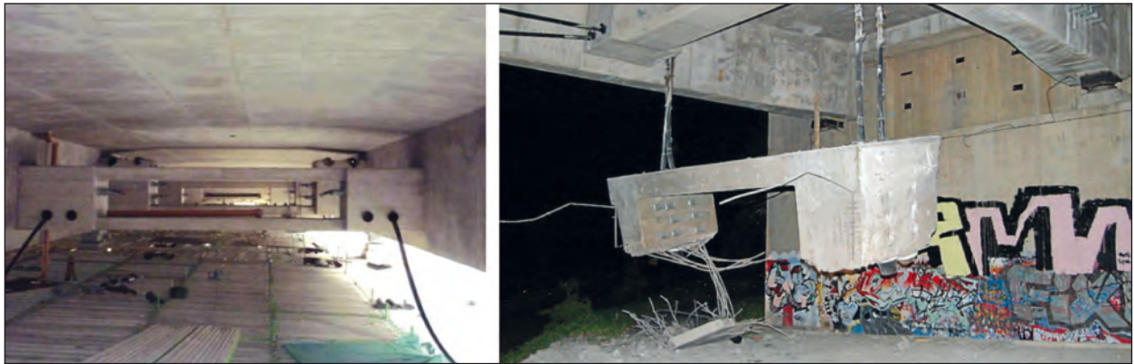
Bild 4: Nachträglich anbetonierte Umlenkstellenkonstruktion [GRAE11] (links), Versagter Endankerblock an der Talbrücke Sechshelden [HELL11] (rechts)
