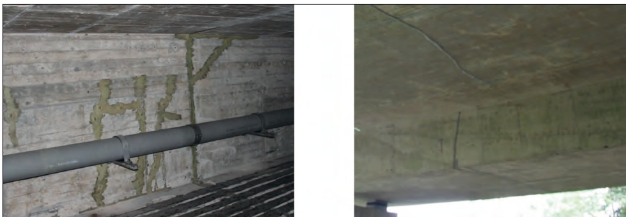
Bild 64: Verpresste Risse im Inneren (links) und an der Außenseite (rechts) des Hohlkastens
