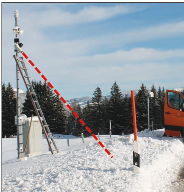
Bild 47: Ausrichtung der berührungslosen Schneehöhenmessung (GMA 5)
