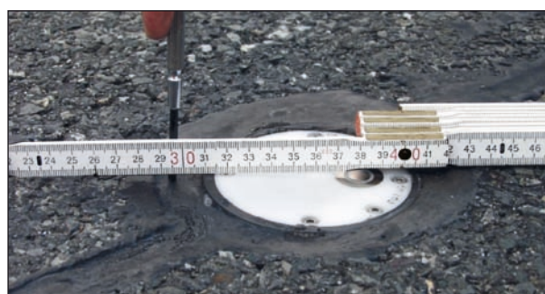
Bild 50: Uneben eingebauter Fahrbahnsensor, vereinfachte Überprüfung mithilfe eines Zollstocks (Quelle: BAST)
