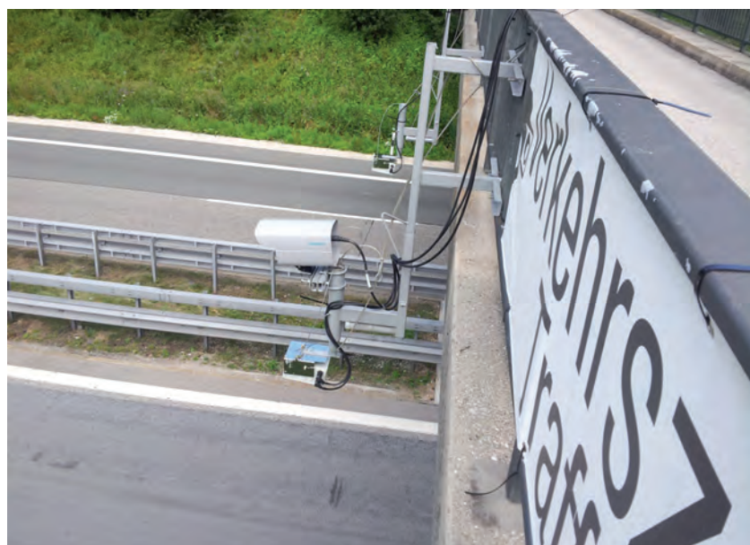
Überkopfdetektoren und Kameras zur Kennzeichenerfassung (Bild: Siemens)
