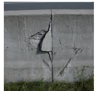
Unterschiedliche Schadensbilder an Schutzeinrichtungen aus Beton
