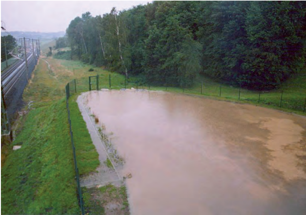
Überlastete Beckenanlage (Bild: Karl Dieffenthal, Landesbetrieb Straßenbau NRW, Außenstelle Köln)
