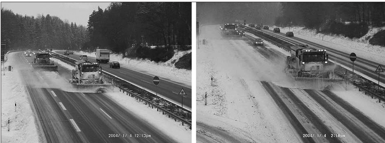
Bild 20: Staffelräumung an der A 5 im Bereich „Rimberg“ am 04.01.2004 mit unterschiedlichen Abständen der Einsatzfahrzeuge
