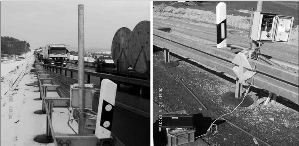
Bild 30: Installierter Radardetektor zur Geschwindigkeitsmessung und zügiges Auslesen der Daten in regelmäßigen Abständen
