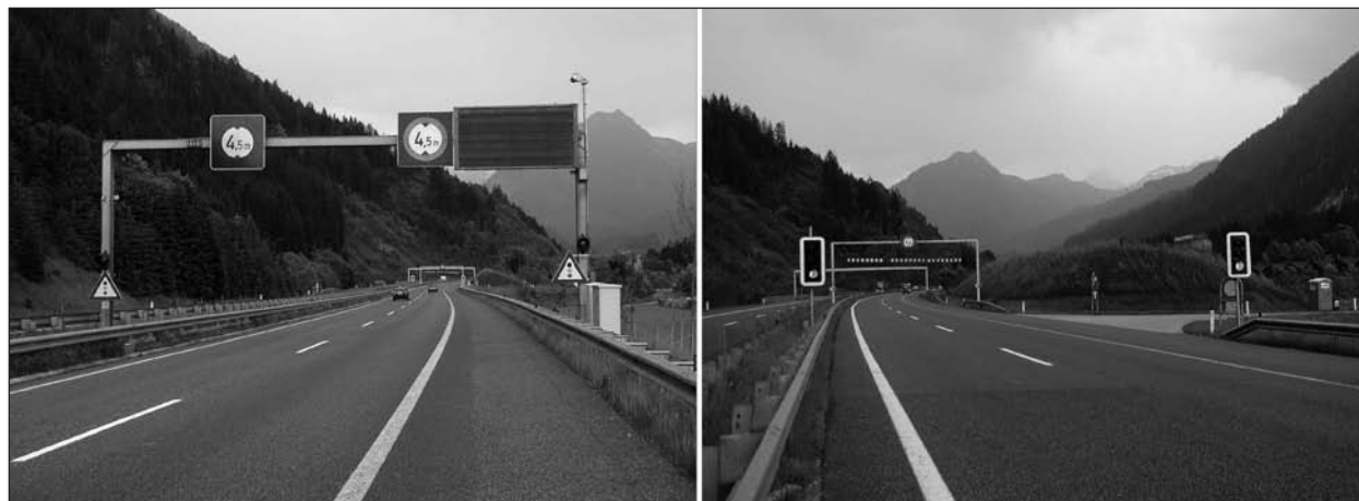
Bild 54: Lichtsignalanlage im Bereich der Höhenkontrolle des Tauerntunnels für temporäre Fahrbahnsperrungen [Bildquelle: AM Flachau, Österreich]
