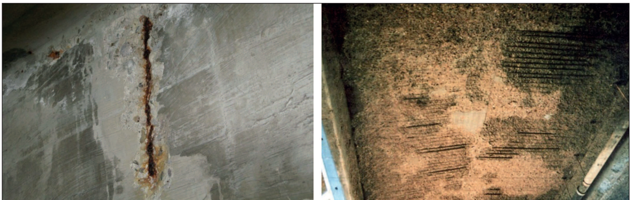
Bild 24: Freiliegende Bewehrung (Fotos: IfM)
