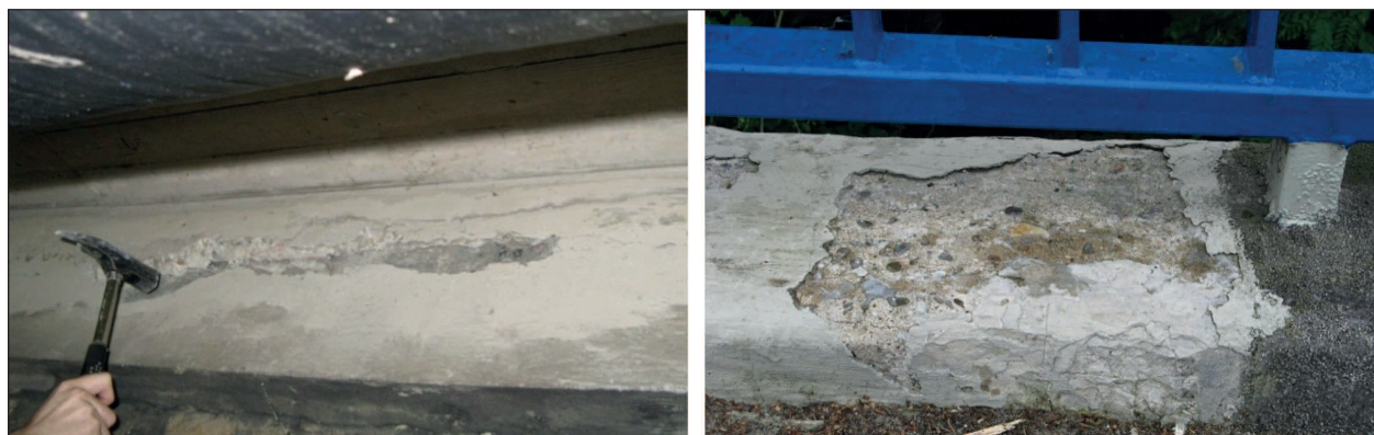
Bild 21: Ausbrüche am Überbau (links) und Abplatzungen an der Kappe (rechts) (Fotos: IfM)
