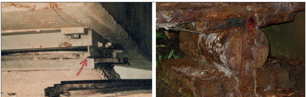
Bild 25: Schäden am Brückenlager (links: Lagerverdrehung, rechts: starke Korrosion am Rollenlager) (Fotos: IfM)
