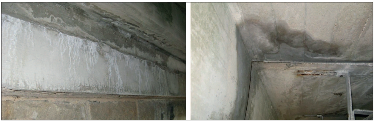
Bild 23: Ausblühungen (links) und Durchfeuchtungen im Hohlkasten (rechts) (Fotos: IfM)
