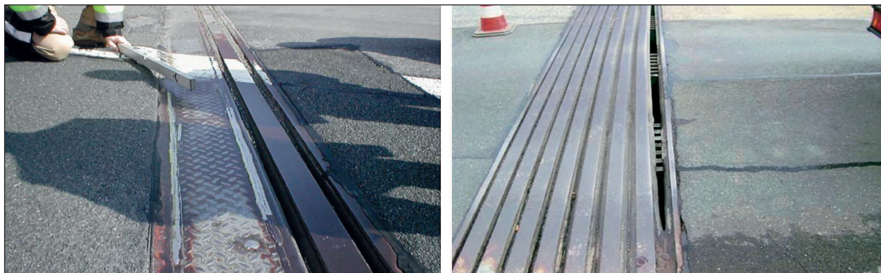
Bild 27: Schäden am Fahrbahnübergang (links: abgesackt, rechts: gerissen) (Fotos: IfM)
