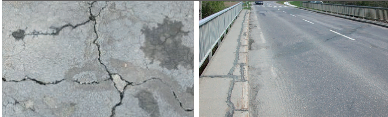
Bild 26: Schäden am Fahrbahnbelag (links) und an der Brückenkappe (rechts) (Fotos: IfM)
