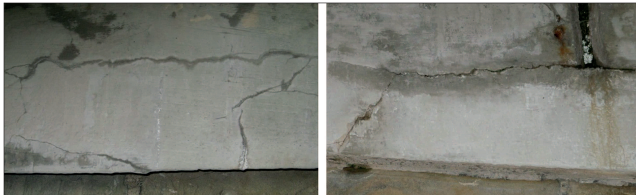
Bild 20: Risse am Überbau (Fotos: IfM)
