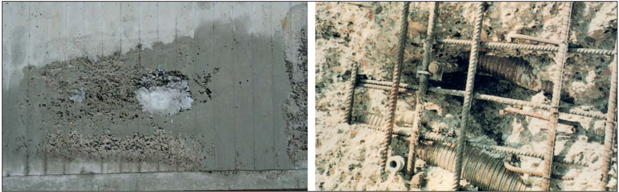
Bild 22: Fehlstelle im Beton (links) und Hohlraum im Bereich der Spannglieder (rechts) (Fotos: IfM)
